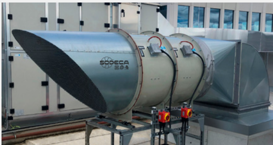
UNTERDRUCKANLAGE IN TREPPENHÄUSERN Penrose Dock, Irland
