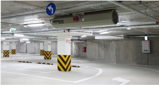
BELÜFTUNG VON PARKHÄUSERN Hotel Sheraton Grand Tbilisi Palace, Georgien
